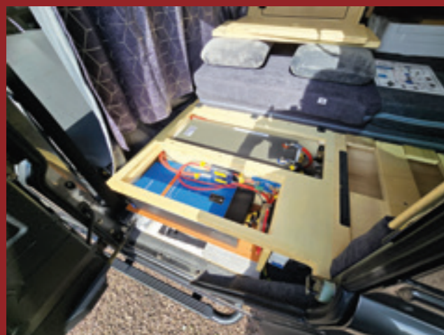
Une partie du système électrique additionnel.
